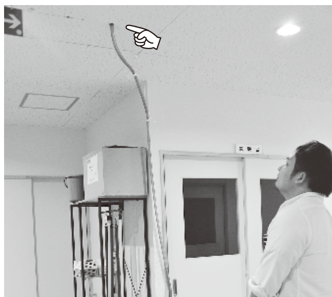
こんなところから雨漏りが
