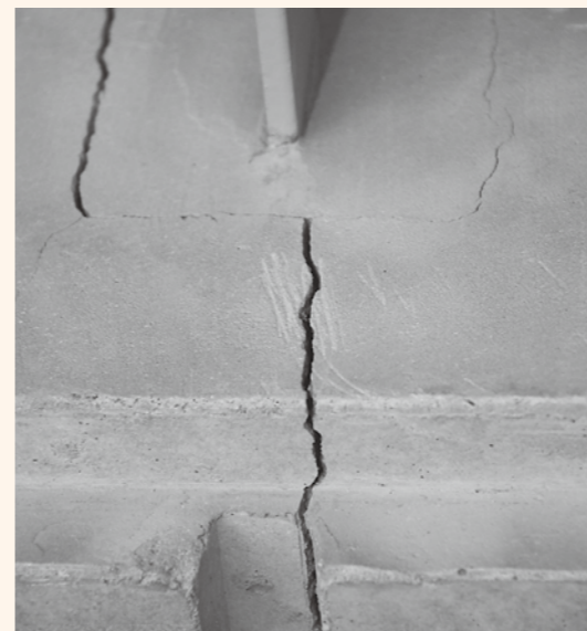
▲西体育館のひび割れ
