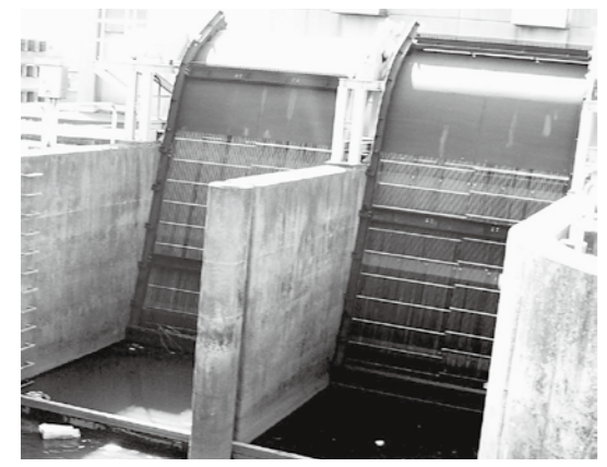
これでも能力不足の排水施設
