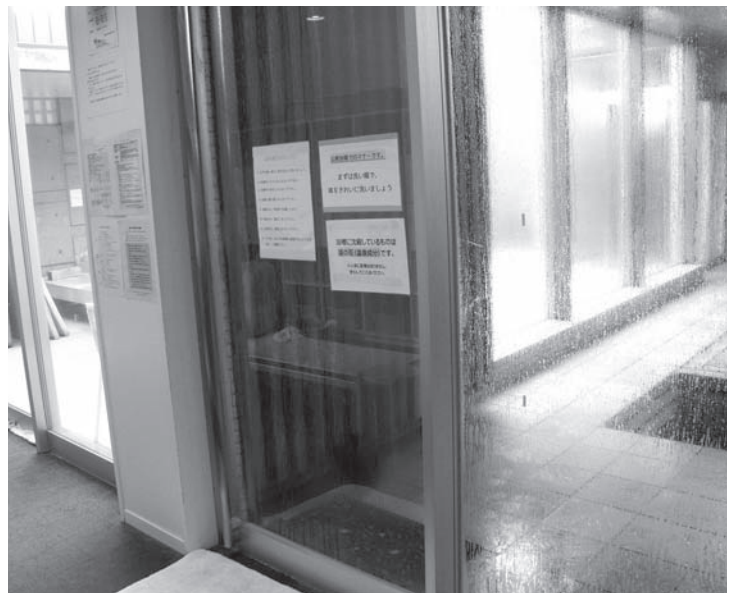
修繕したのになぜ重い 町湯浴場入口ドア
