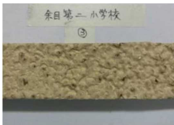
写真-1 採取したシーリング材 参考：令和元年度の余目第二小学校調査より
