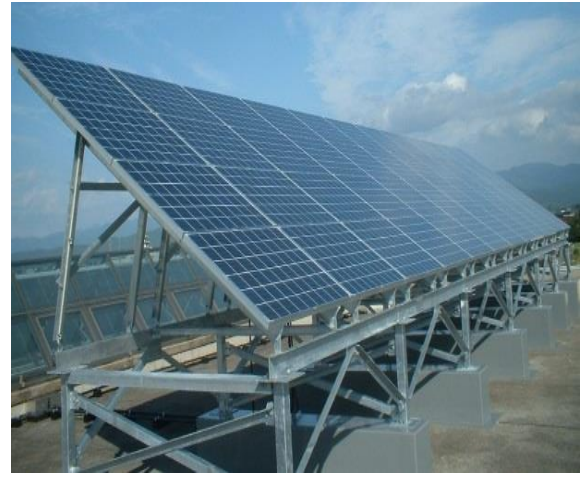
響ホールの太陽光発電
