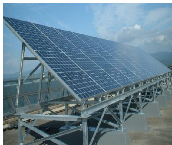
響ホールの太陽光発電
