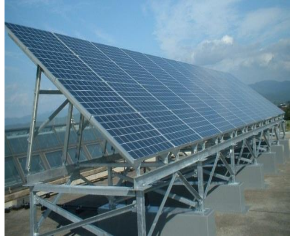
響ホールの太陽光発電
