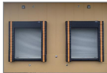
② ドックシェルター
