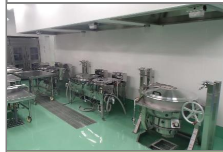
⑦ 焼物・揚物・蒸物調理室
